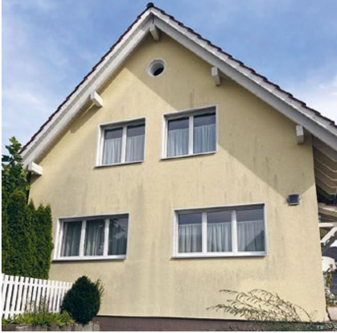
Putzfassade mit Grünalgenbefall
