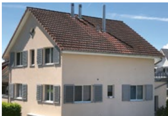
Dach mit Algen-, Flechtenbefall
