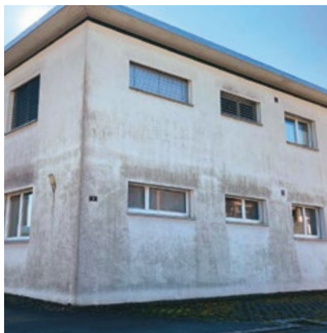
Putzfassade mit Algen-, Flechtenbefall
