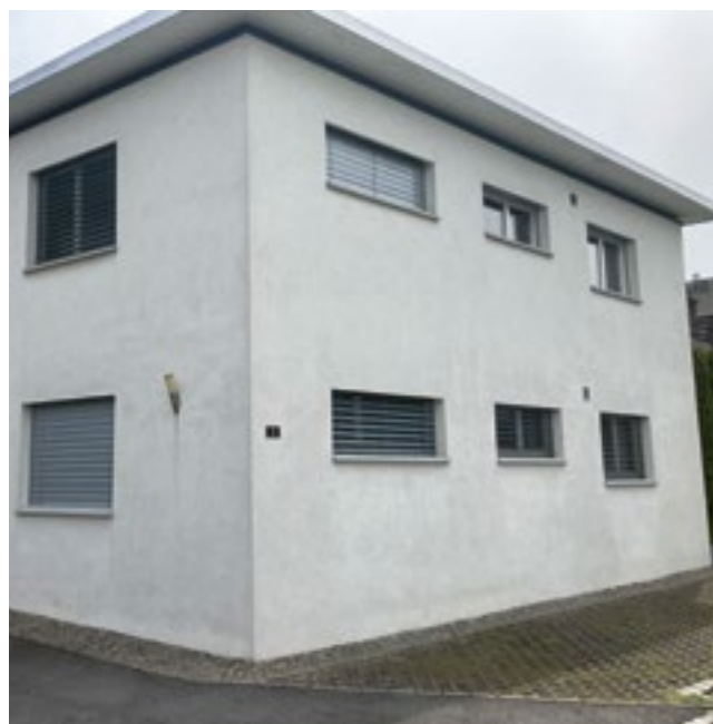
Fassade ca. ein Jahr später
